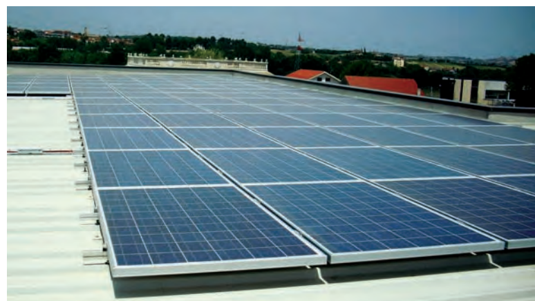
Impianto fotovoltaico da 20 kWh 20 kWh photovoltaic installation
